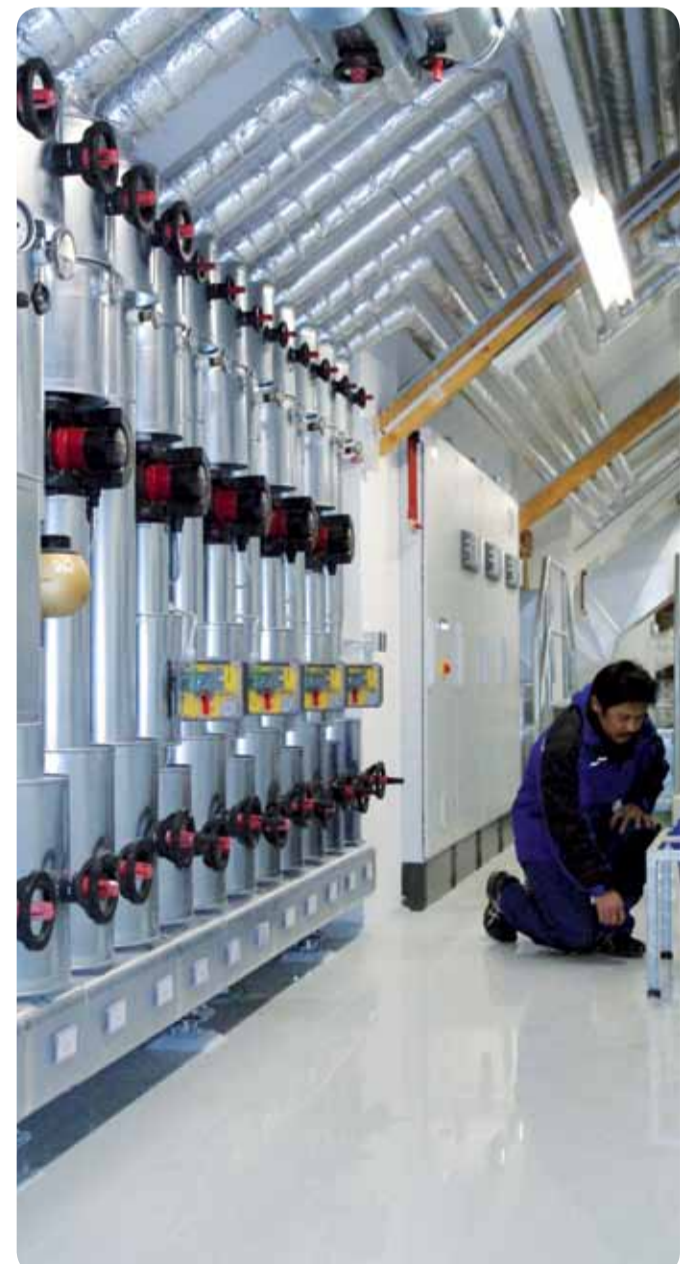
Wärmeverteilung im Dachgeschoss
