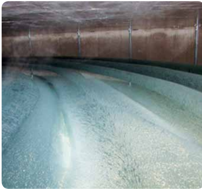
Eisspeicher von innen
