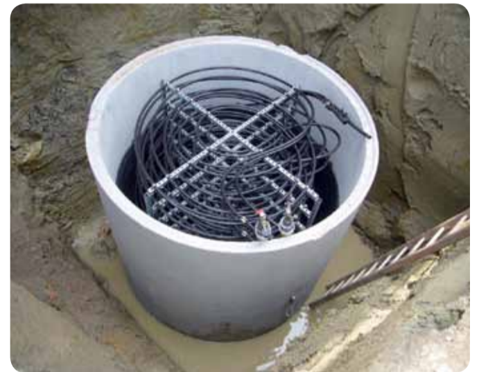
SolarEis-Speicher für ein Einfamilienhaus
